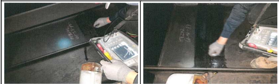
<사진 3.3.1> 맞대기용접부 결함조사(UT)
